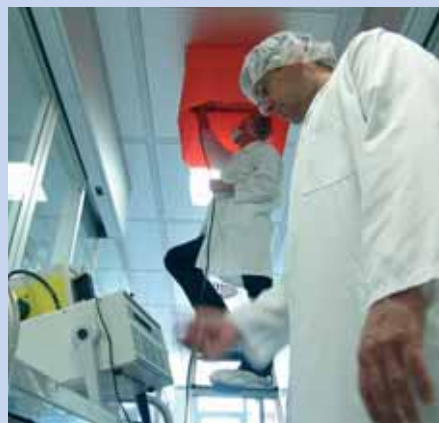
Filterlecktest an den endständigen HEPA Filtern
