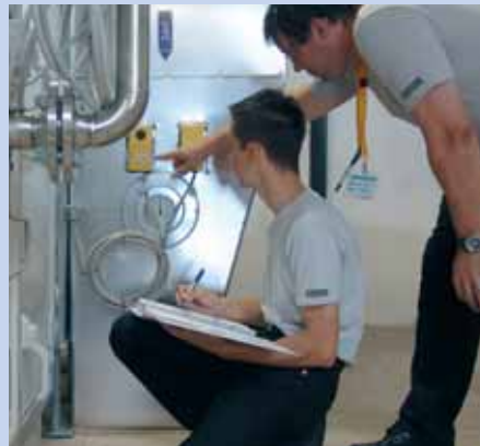
Qualifizierung der Lüftungsanlage
